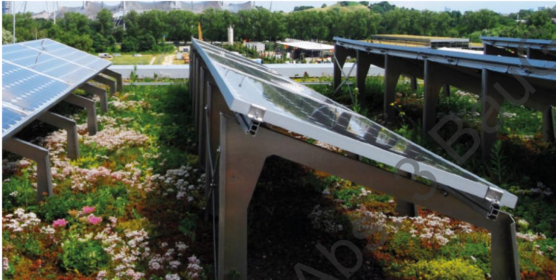
Abbildung 3: Solaranlage auf Gründach – beispielhafte Umsetzung 1
