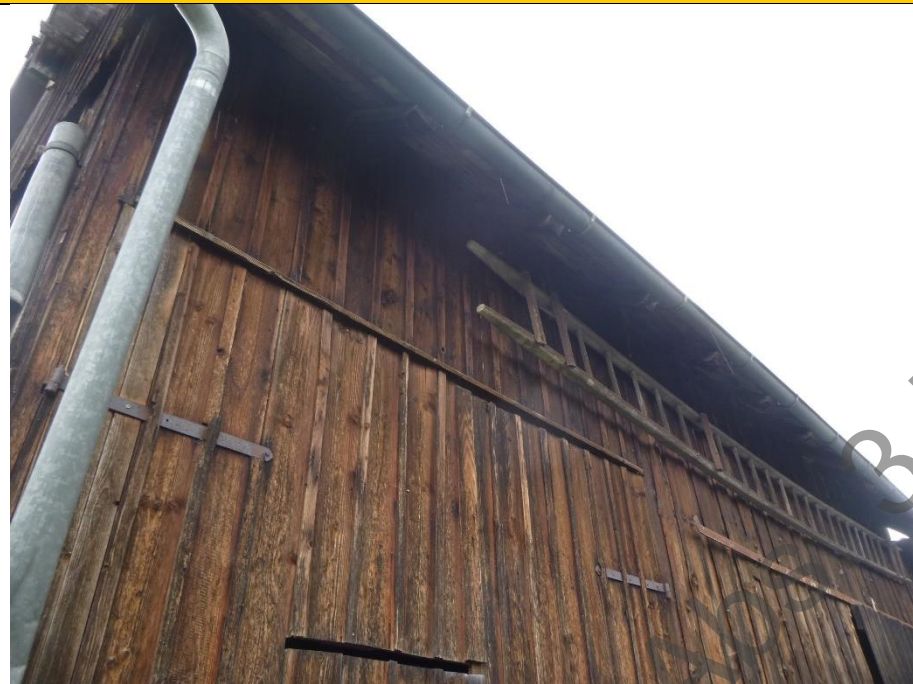
Abbildung 3: Hausfassade eines Gebäudes mit mehreren Spalten und offenen Türen
